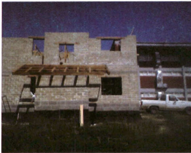
Foto 45. Detalle de losa azotea cuarto de baterías
