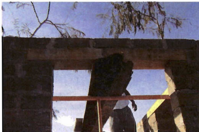
Foto 22. Detalle de dinteles de madera
