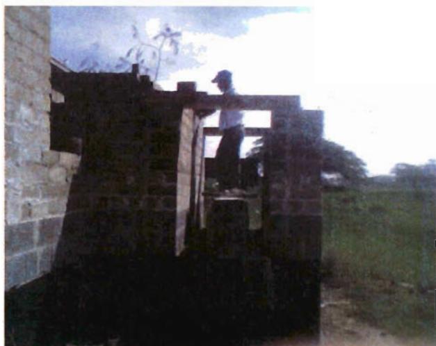
Foto 23. Dintel de madera en cuarto de baterías
