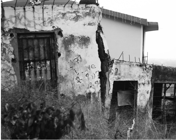
Figura 7. Vivienda deteriorada de materiales convencionales por efecto del clima y el abandono, en Tampico, Tamaulipas. Fotografía: J. A. Espuna
