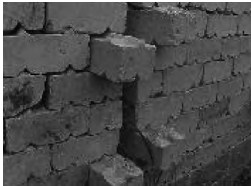
Figura 7. Fotografías de los muros machihembrados y su deterioro.
