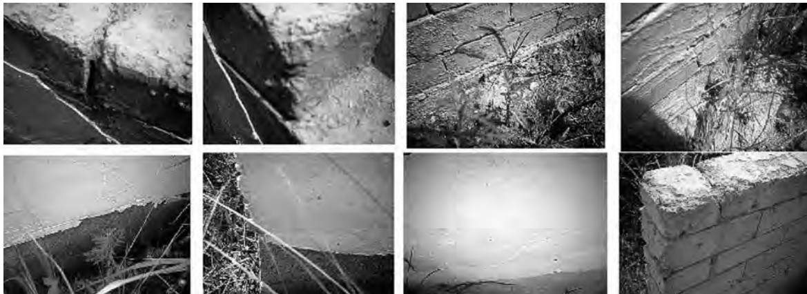
Figura 24. Las fotografías muestran el estado que guardan los muros de los octágonos 1, 2 y 3
