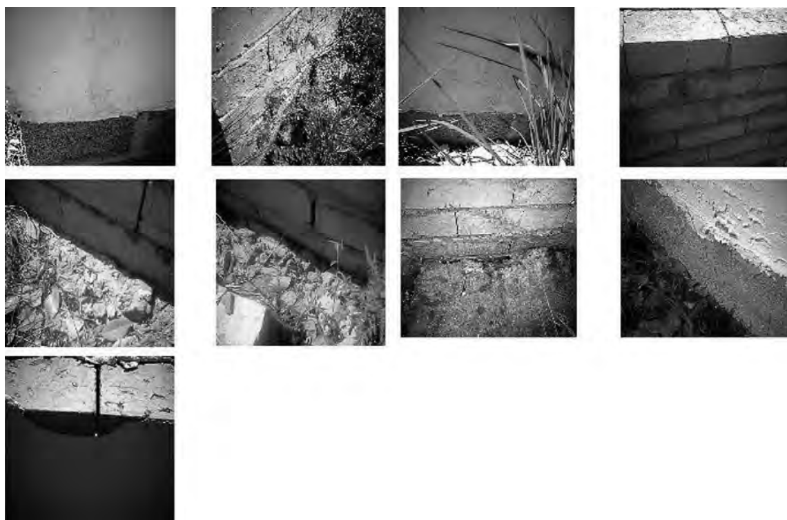
Figura 22. Las fotografías muestran el estado que guardan los muros de los octágonos 1, 2 y 3
