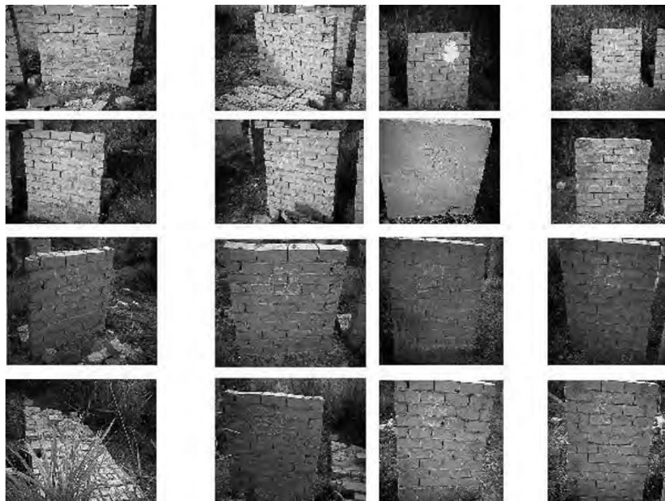
Figura 4. Fotografías de los muros del octágono núm. 4, en el orden en que se indican en el cuadro superior
