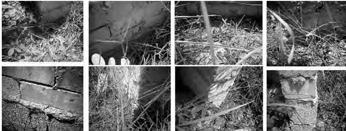
Figura 25. Las fotografías muestran el estado que guardan los muros de los octágonos 1, 2 y 3
