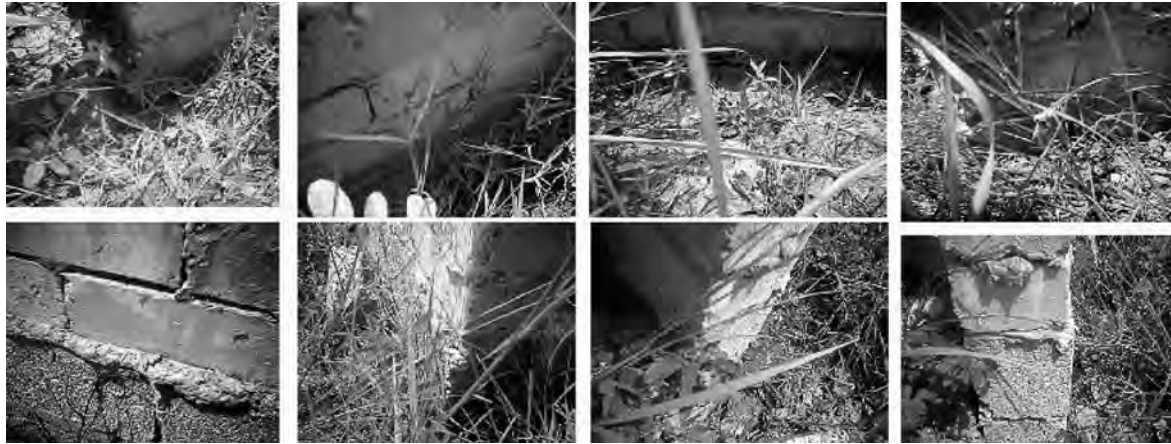
Figura 26. Las fotografías muestran el estado que guardan los muros de los octágonos 1, 2 y 3
